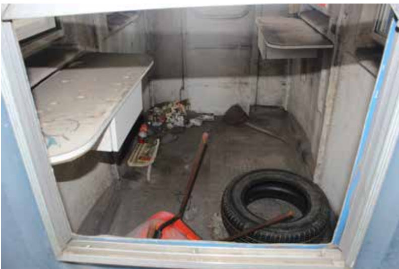
Abandono: cabines de segurança viram depósito de lixo e entulhos.
